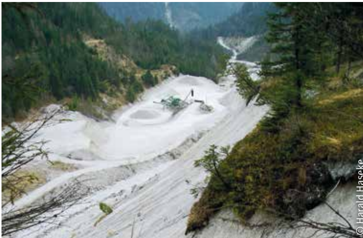
Die Schotteraufbereitungsanlage im Weißenbachl von der Geländekante oberhalb des Abbaus fotografiert.
